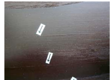
ウレタンS：導管に沿って大きい割れが発生。
